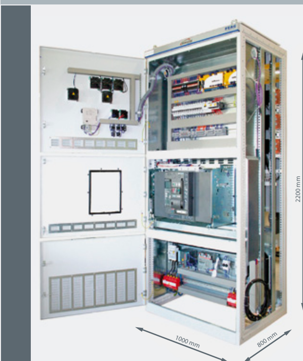
Шкаф типа L: Секционный силовой выключатель выкатного исполнения
